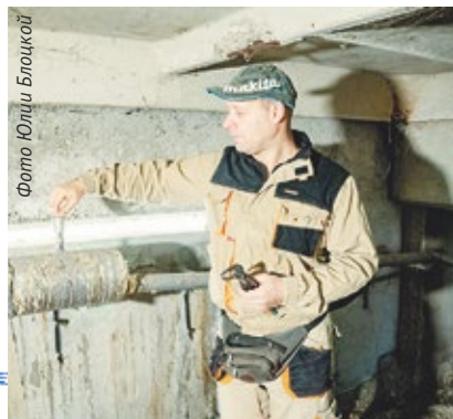
Слесарь спустит воздух, открыв запорную арматуру, после чего тепло поступит в каждую квартиру
